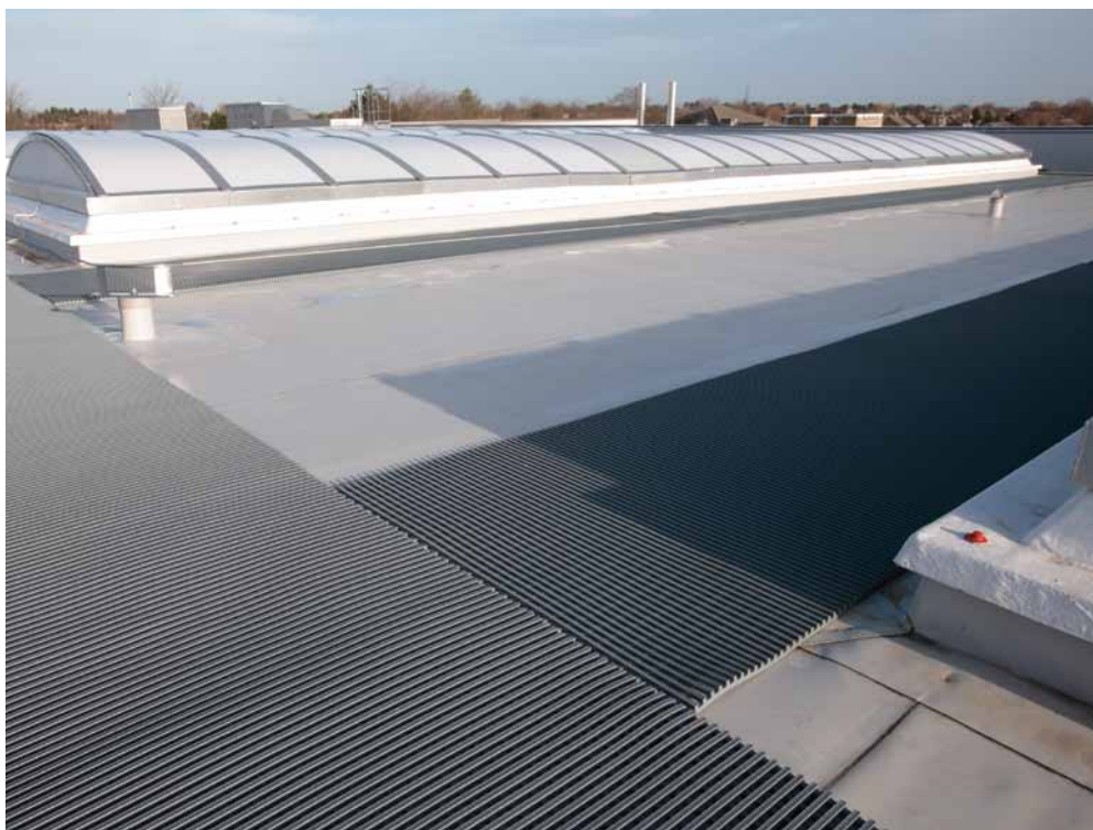
Zona de área técnica y pasillos técnicos
